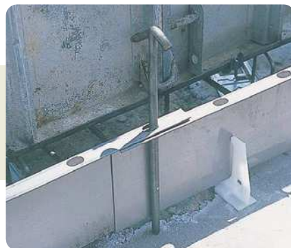
10. 鉄ベース枠の繋ぎ部は125mmほど重ね、鉄ベース枠の穴の位置を合わせて樹脂スペーサーをセットします。この時、重なった部分の穴を鉄ベース枠支持棒で杭打ちして固定します。
