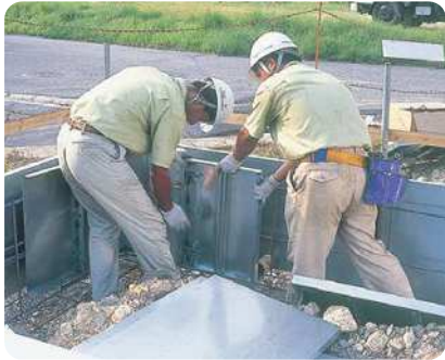
6. 立ち上がり型枠をM型鉄筋ベースの上に順次組み付けていきます。
