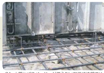
21. 土間セバスパーサーが使えない特殊寸法部では、シングル鉄筋ベースを入れて対応する事ができます。
