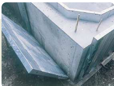
27. 直線部のパネルを順次外していきます。脱枠には脱枠棒が便利。
