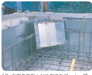
12. 内周の立ち上がり型枠もコーナー部から設置していきます。
