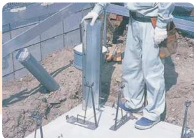
9. 外周の立ち上がり型枠をコーナー部から設置していきます。
