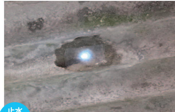
止水 Water stop スレート屋根の漏水補修 Slate roof water leakage repair
