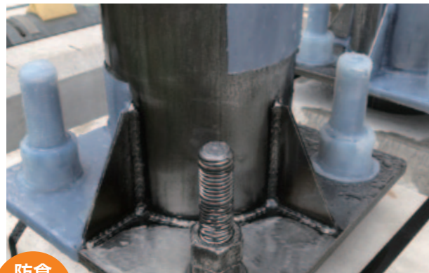
防食 Anti-corrosion アンカーボルトナットの防食 Corrosion protection of anchor bolt nuts
