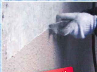
ショッピングモール 外壁塗膜剥離
