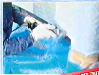
ホテル外壁塗膜剥離
