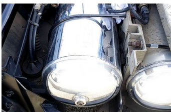
▲エアータンク
