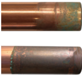
腐食した銅管
