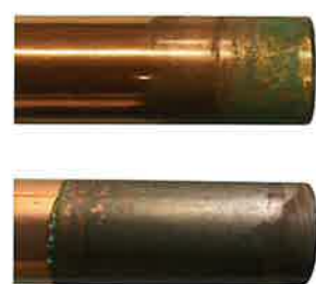
腐食した銅管
