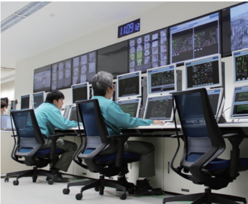
● セメント製造にたずさわるすべての設備・機器は、コンピュータ制御で運転されます。制御室ではプラントの運転状況を24時間リアルタイムで監視し、仕様に準じた各種セメント製造をコントロールしています。
