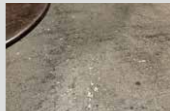
椅子の引きずりによる剥がれ
